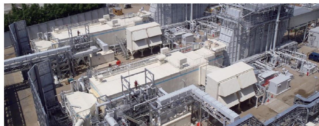
納入先 プラント名(国名) 出力 運転開始年 東北電力株式会社 新潟火力発電所5号系列(日本) 10.9万kW 2011年
