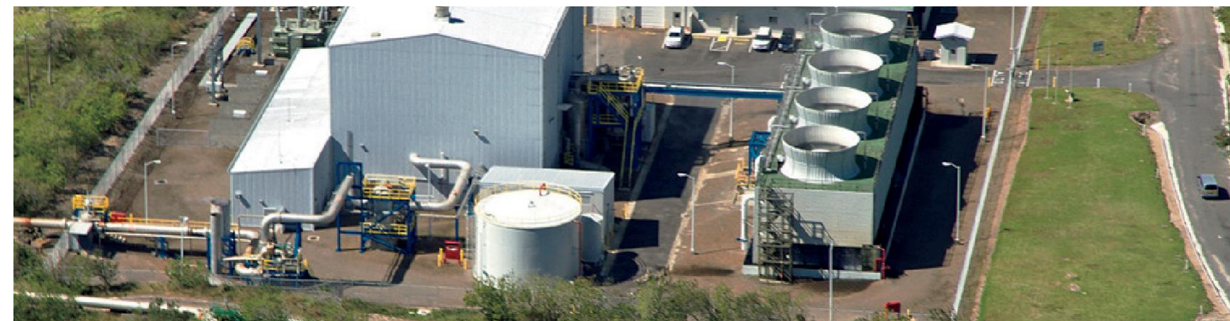
納入先 プラント名(国名) コスタリカ電力公社 ミラバジェスIII発電所 (コスタリカ) 出力 2.7万kW 運転開始年 2000年
