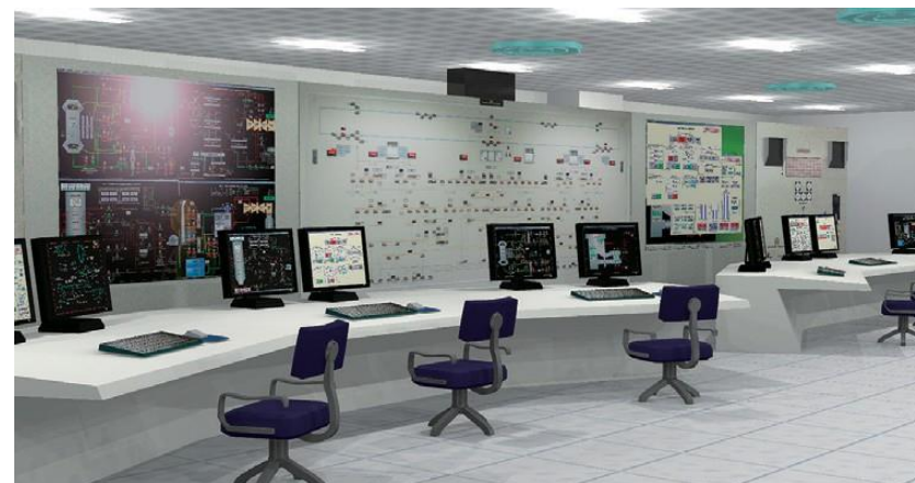
➤ 制御システム
